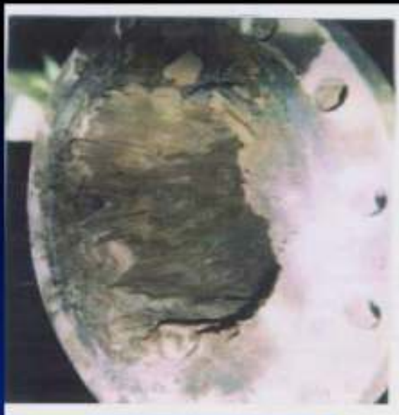
BSC設置前700A配管
